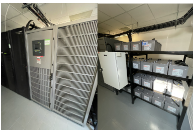
Figures 8 : Salle A de l'onduleur et ses batteries pouvant tenir ~8h en cas de coupure complète
