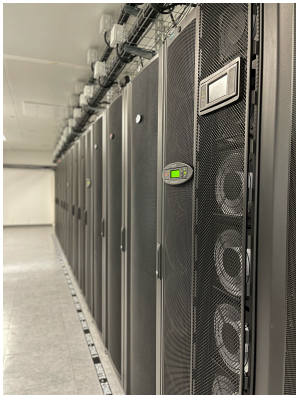
Figure 5 : Baies data center la Ciotat
