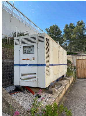
Figures 6 : Générateur de secours A et B de puissance respective 870 et 400 kvA
